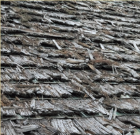
屋根板の傷んだ状況
